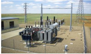
Subestación eléctrica (existente)
